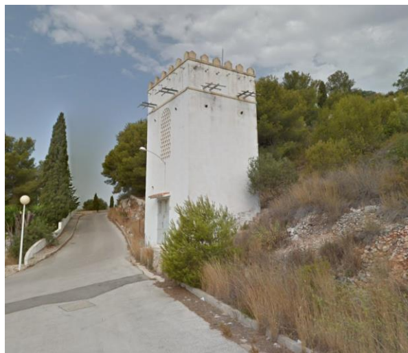
Caseta Centro de Transformación Santa Lucía, en Xàbia.
