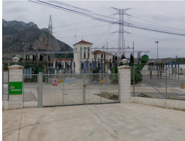
Subestación eléctrica de El Verger.
