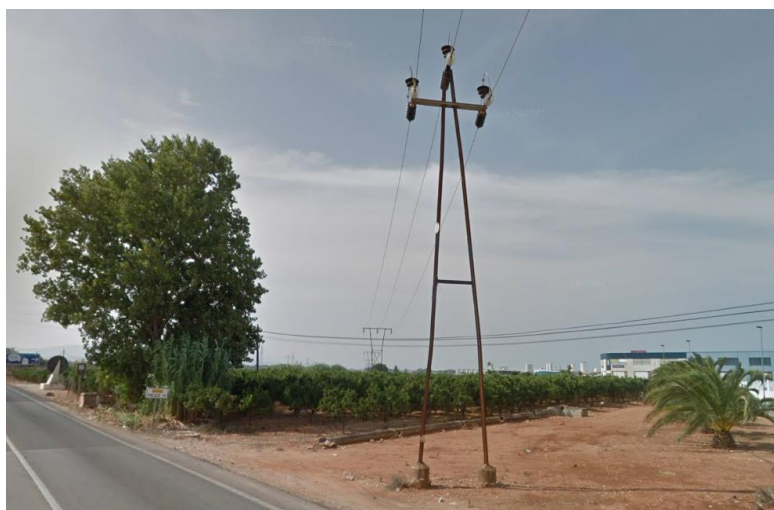
Apoyos de la línea eléctrica Gandía-Oliva-El Verger.
